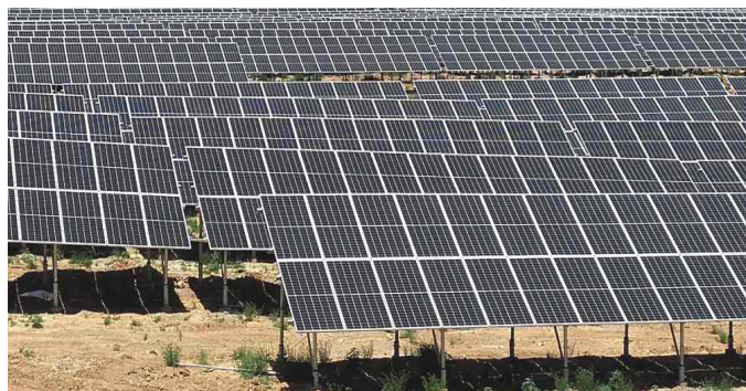
山西吕梁130兆瓦光伏电站全部使用爱浦克施塑箱 All 130 MW photovoltaic power plants in Luliang, Shanxi use IPKIS plastic boxes
