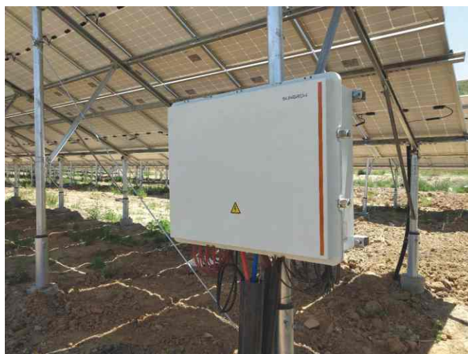
合作伙伴阳光电源越南1500V光伏电站 Partner Sunshine Power Vietnam 1500V Photovoltaic Power Station . 该项目共使用我司SMC密封箱1735台 The project uses a total of 1735 SMC sealed boxes.
