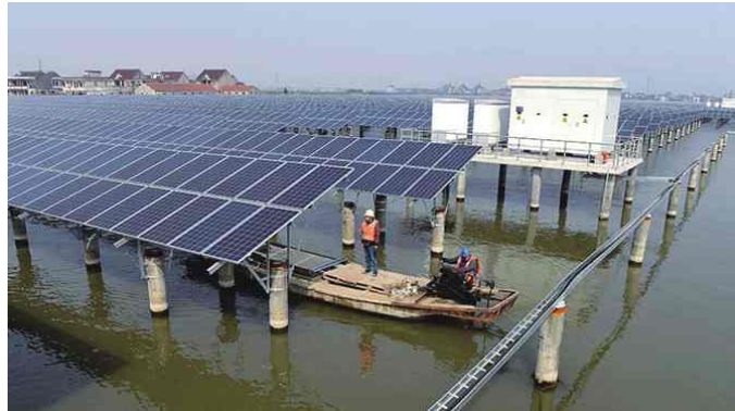
水上光伏项目 Water photovoltaic project
